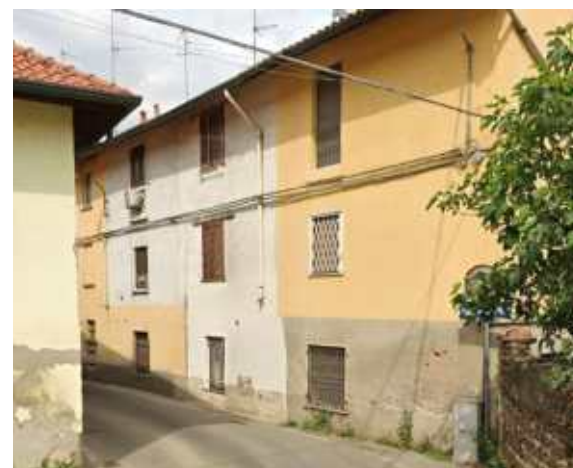
Edificio rurale originario con l'introduzione di elementi linguistici incongrui (partitura di facciata modificata con elementi di chiusura incongrui, impianti in facciata, ecc..)
