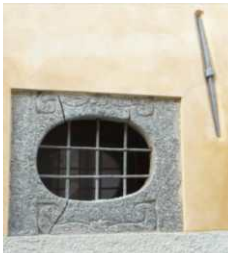
Esempio di riquadro decorativo lapideo da mantenere
